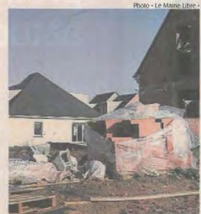
Château-du-Loir, jeudi 1er avril 2010. Des stocks de matériaux attendent depuis de longs mois une hypothétique reprise du chantier.
